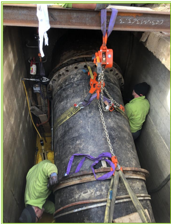
Öffnen der Druckleitung 2
